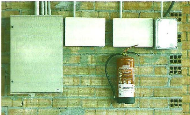
Figura 3.1. Imagen de cuadro eléctrico.
